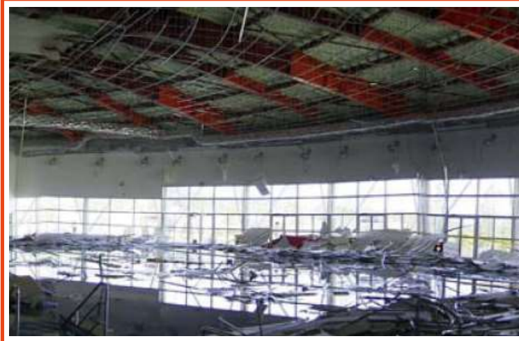
2005/8/16 宮城地震 国土交通省平成17年8月26日「スパーク松森における天井落下事故調査報告」より
