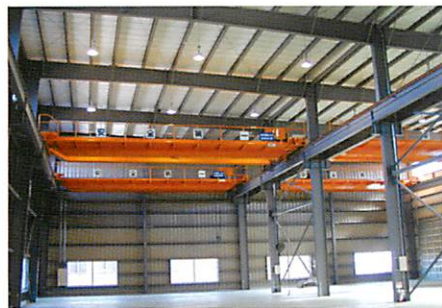
天井走行クレーン (1.0t ~ 20.0t 程度)
