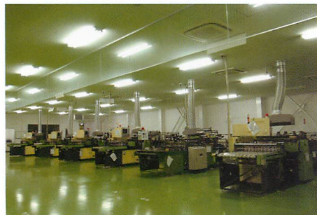
地盤沈下により、機械に傾きが発生
