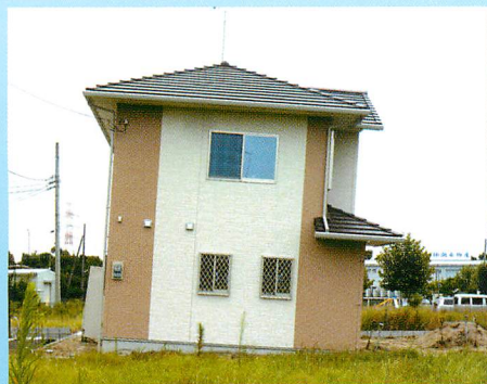
施工前（右方向に大きく沈下）
